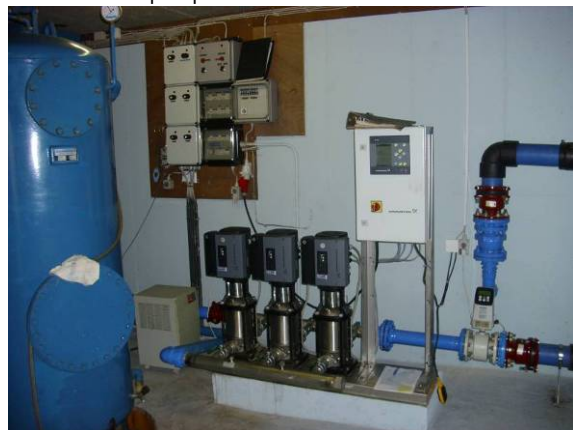
Foto af rentvandspumper
