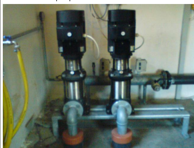
Foto af rentvandspumper
