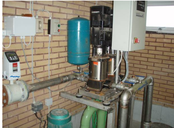
Foto af rentvandspumper
