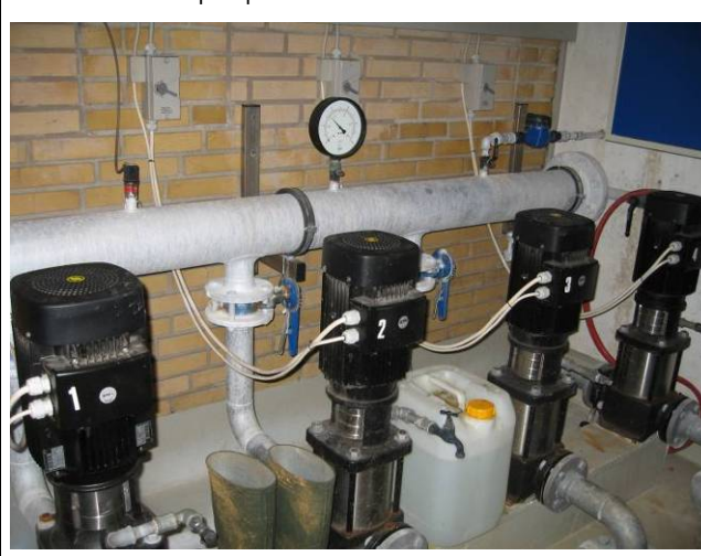
Foto af rentvandspumper
