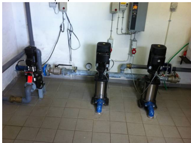
Foto af rentvandspumper
